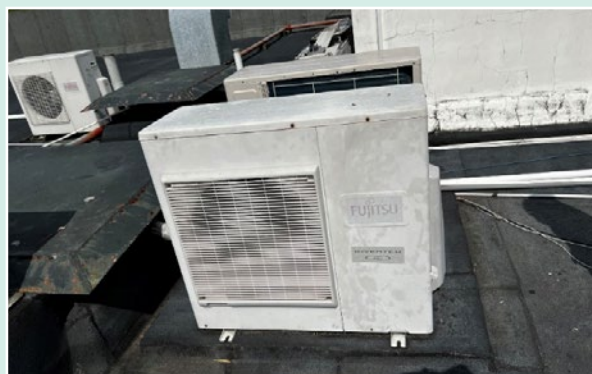
Hệ thống làm mát (Thực địa)
